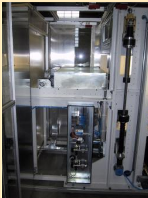
Saldatrice ad azionamento elettrico: zona carrello-lama
